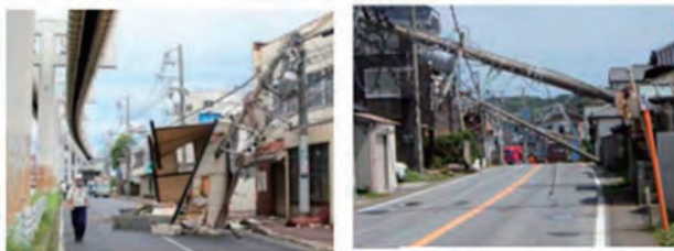
図表 3. 暴風による電柱被害の様子（出典 3）
