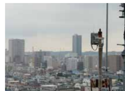
八王子市役所屋上の電波受信アンテナ
