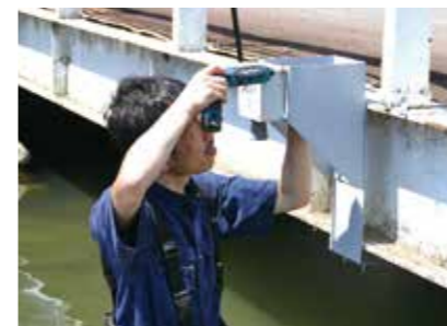
橋梁へのセンサー設置の様子
