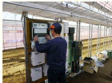
最新鋭のハウス設備
