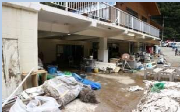
豪雨による浸水被害を受けた施設(秋川漁協:令和元年)
