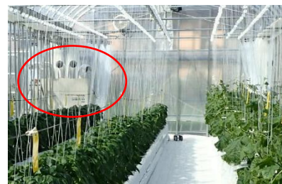
ヒートポンプ
