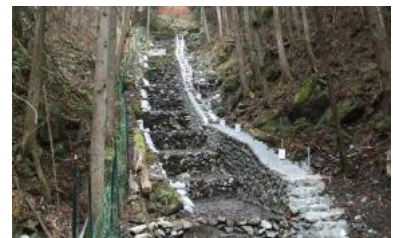
奥多摩町のワサビ田 (上段：被災時、下段復旧後)
