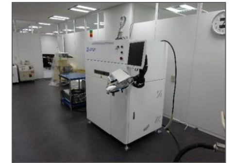
電源改修により設置できた 3D プリンター
