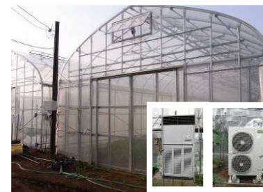
〈省エネ環境施設〉 ヒートポンプ設置による加温栽培
